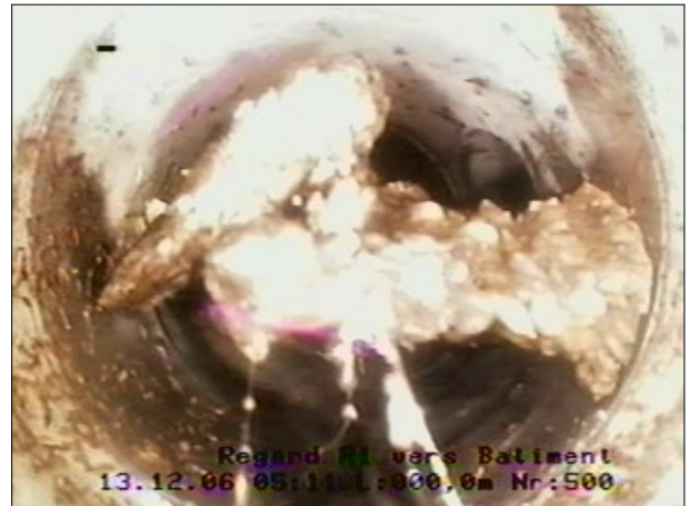
Photo: 1_2b, Réf. bande vidéo: CD Vidéo important dépôt solide, conduite obturée par du béton, branchement à droite (siphon chaufferie) visible
